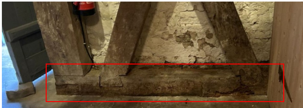
Die Abbildung zeigt den schadhaften Balken am Ausgang aus dem Turm.
